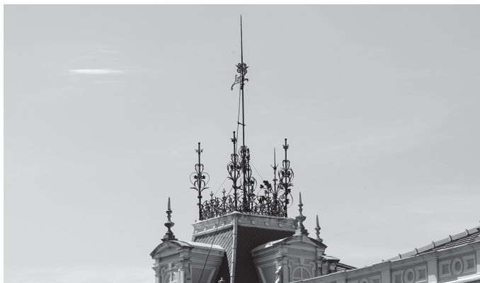
Figura 3. Para-raios tipo Franklin no topo de uma edificação.
